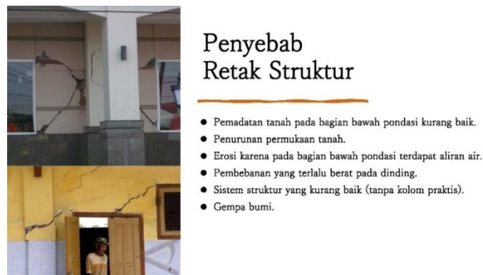
Gambar 5 Penyebab retak struktur pada dinding
