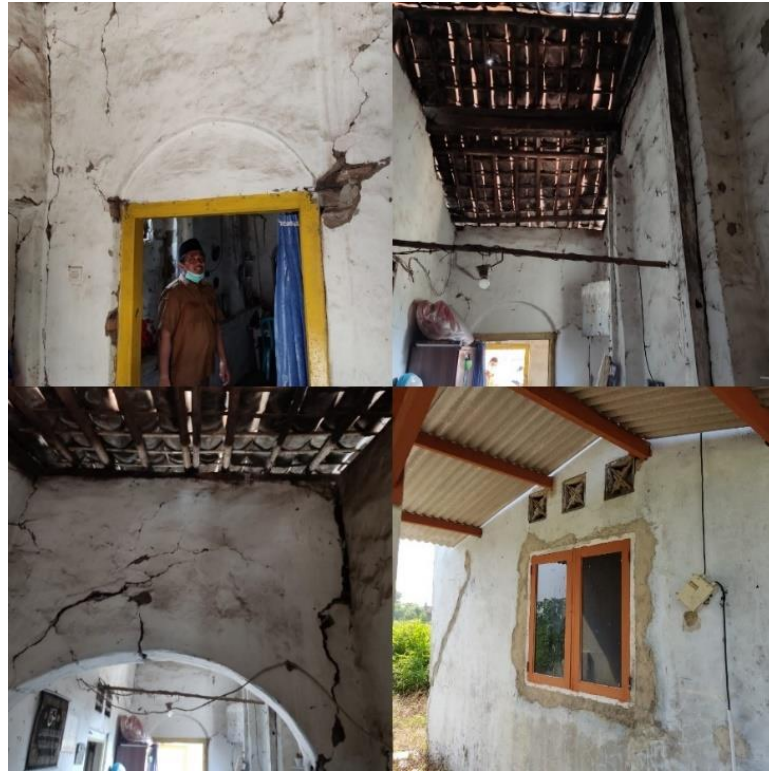
Gambar 2 Retak dinding rumah penduduk Kelurahan Bendung
