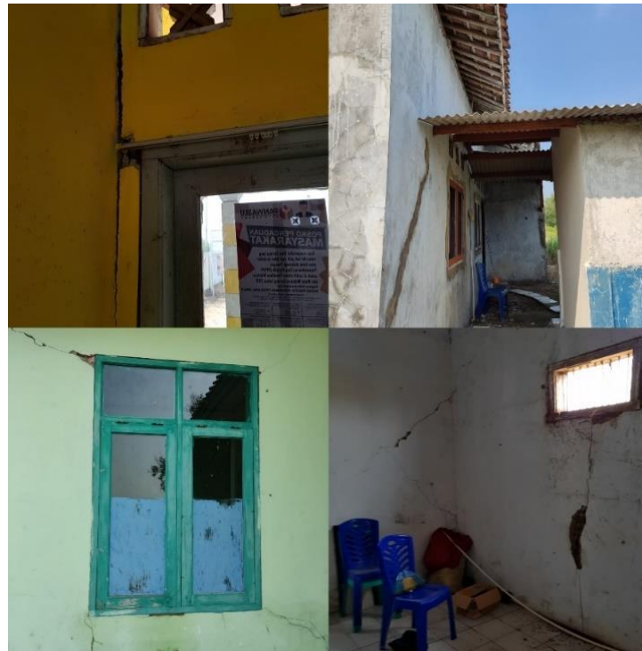
Gambar 3 Retak dinding kantor Kelurahan Bendung
